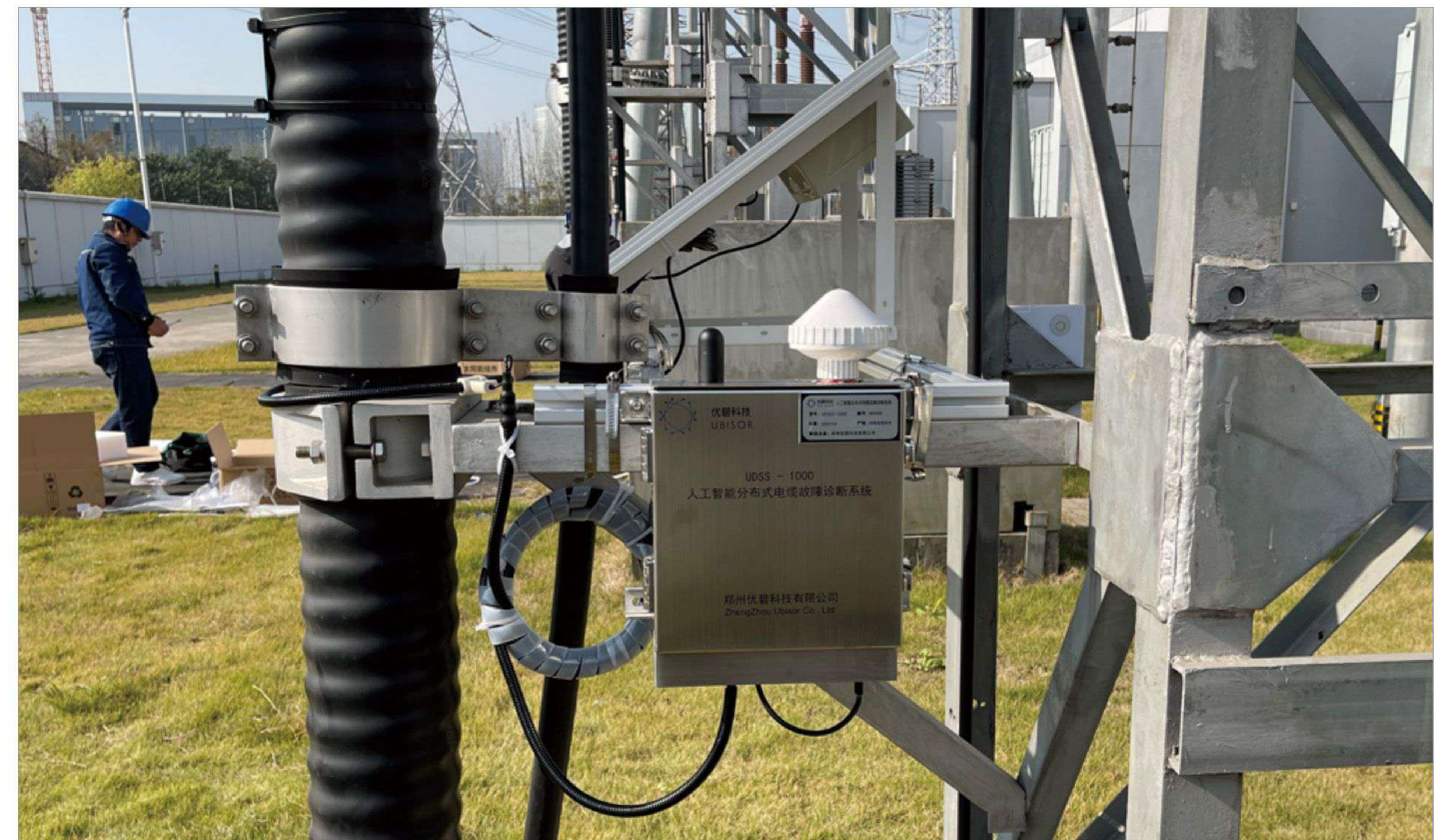
500kV电缆线路应用案例
