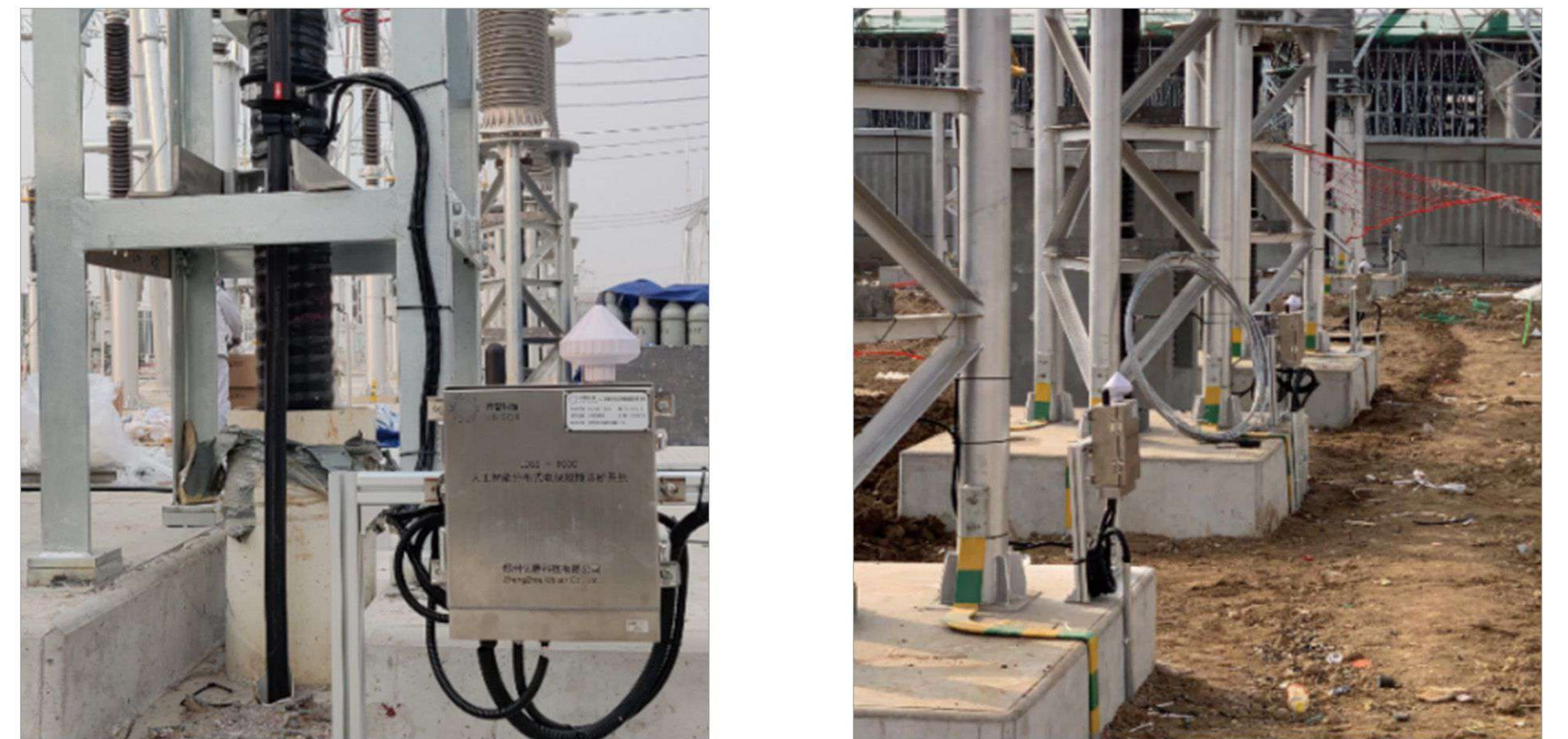
330kV电缆线路应用案例
